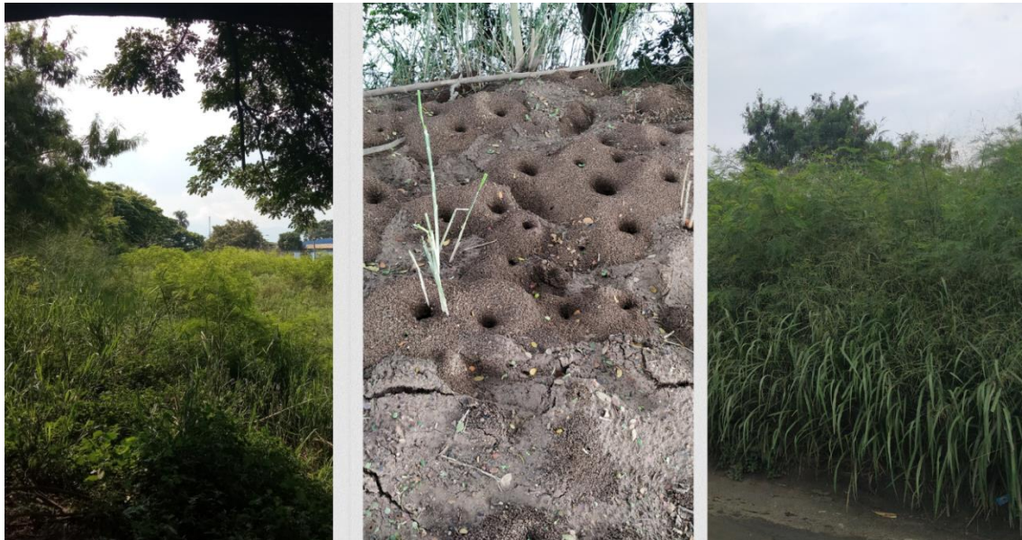
Estado del Jarillón días antes del mantenimiento.
